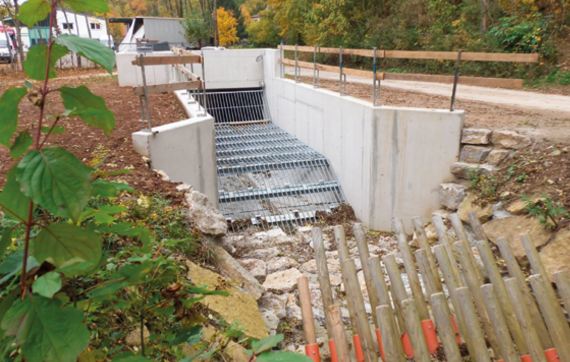
Abb. 78: Neue gebauter Kanalisationseinlauf an einem Bach. Bei Starkregen gilt es, diese Einmündungen immer offen zu halten, damit das Wasser in der Verdohlung bzw. in der Kanalisation abfließen kann.
