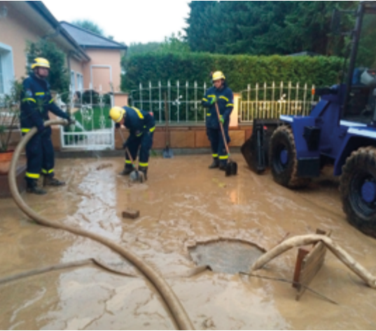
Abb. 23: Aufräumarbeiten nach einer Sturzflut in Sinsheim
